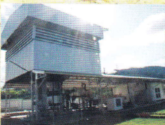
โรงไฟฟ้าชีวมวลโดยใช้เทคโนโลยีแก๊สซิฟิเคชัน ขนาด 160 kW ของบริษัท ซุปรีม รีนิวเอเบิล เอ็นเนอร์ยี จำกัด Supreme Renewable Energy Co., Ltd's 160-KW Biomass Power Plant Using Gasification
